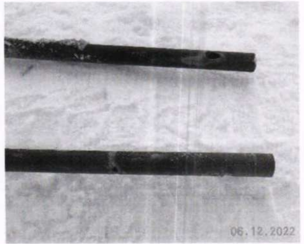
Места прохождения тока КЗ и прожига металлических труб
